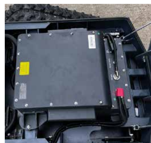
BATTERIE LITHIUM ION
